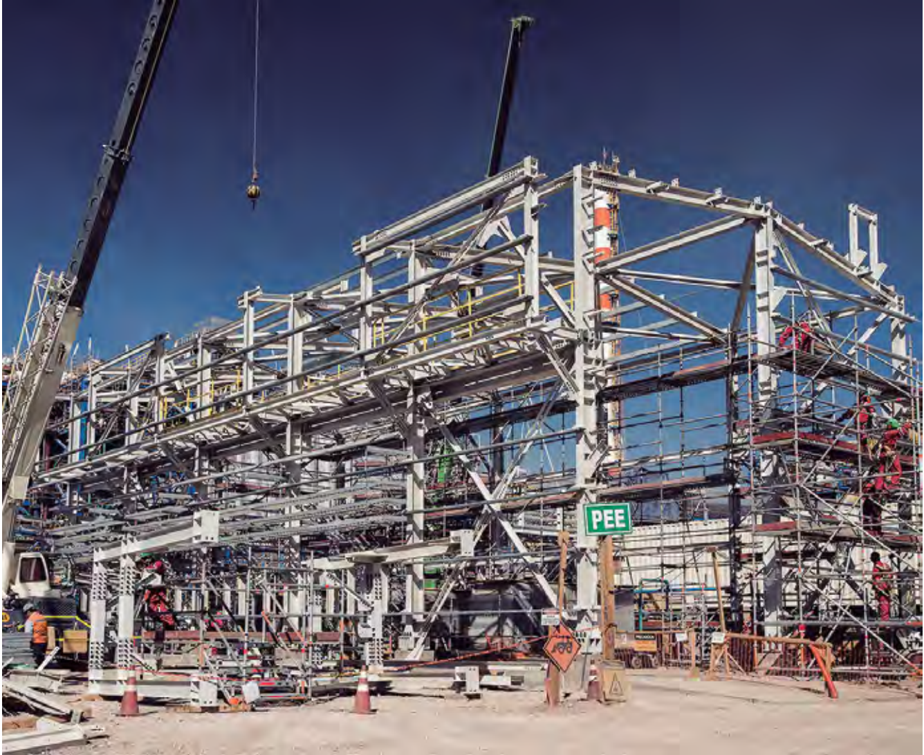
Sala Compresores Tostación Minera Ministro Hales, Calama - Chile
