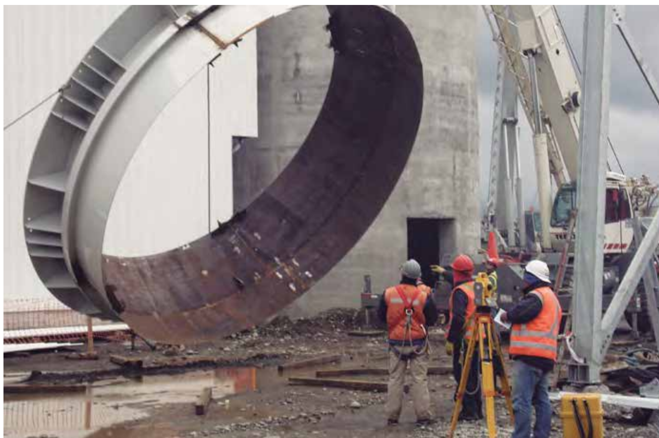
Colaboradores Proyecto Planta de Cementos Trapén Lafarge, Puerto Montt - Chile
