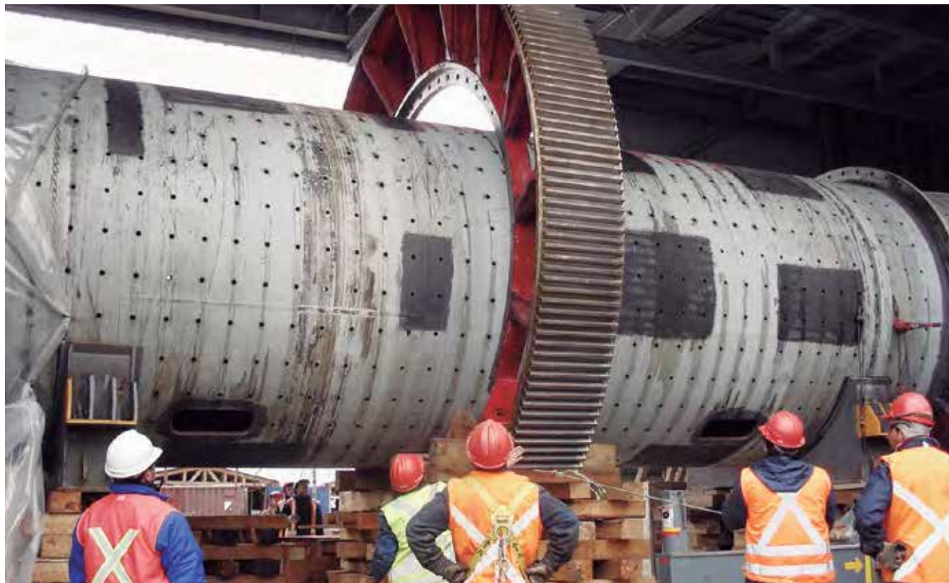
Colaboradores Proyecto Planta de Cementos Trapén Lafarge, Puerto Montt - Chile
