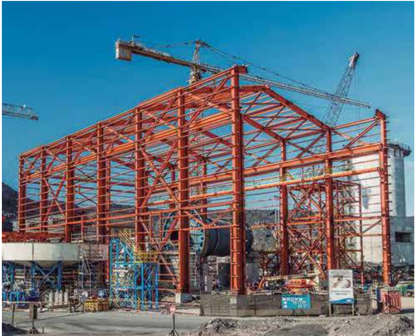
Planta Pellets Minera del Pacífico, Huasco - Chile
