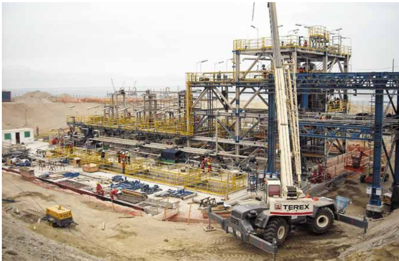
Planta Gas Natural Licuado, Mejillones - Chile
