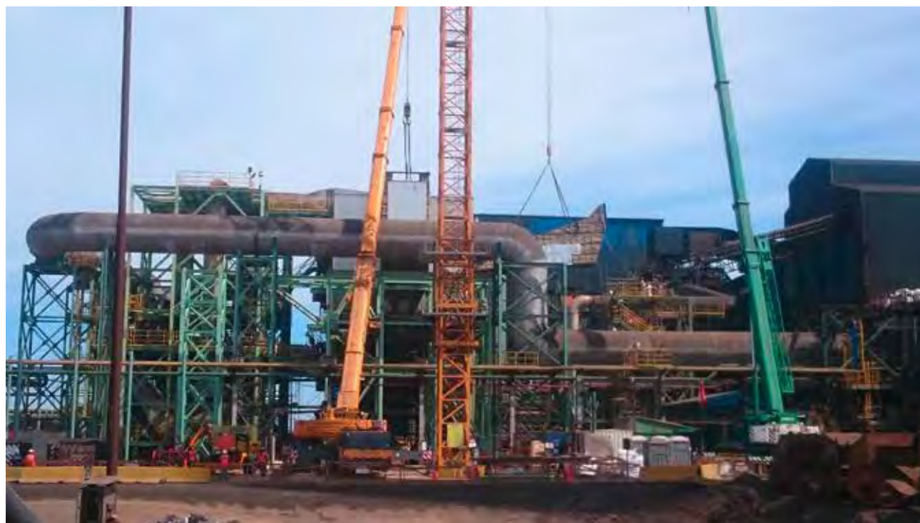
IMPLEMENTACIÓN SISTEMA DE CAPTACIÓN GASES SECUNDARIOS CT, CODELCO, VENTANAS – CHILE
