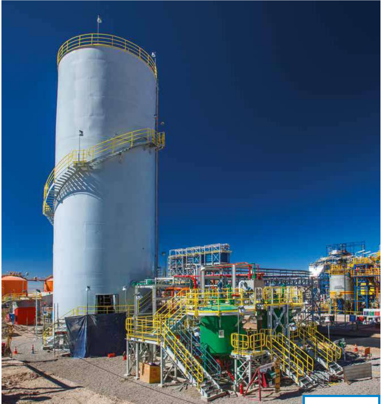
PLANTA LECHADA DE CAL MINISTRO HALES, CODELCO
