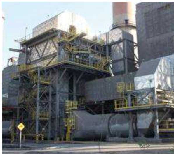
Planta de Desulfurización Ventanas, AES Gener
