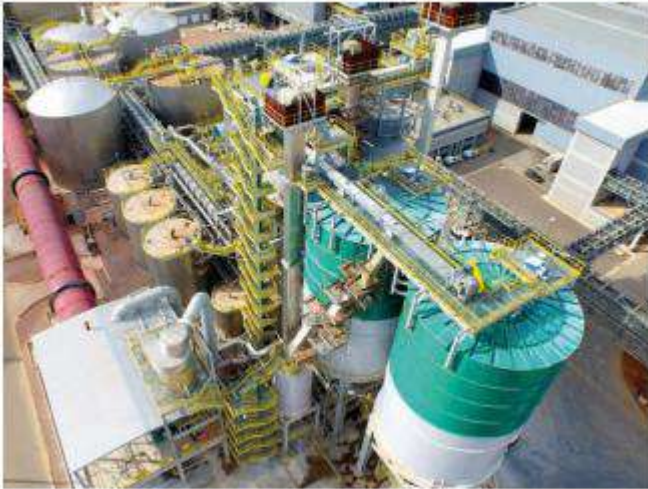
CAUSTIFICACIÓN Y HORNO DE CAL, PLANTA CMPC GUAIBA - BRASIL
