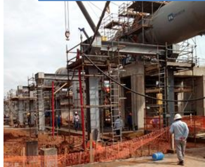
Caustificación y Patio de Maderas, Suzano - Brasil
