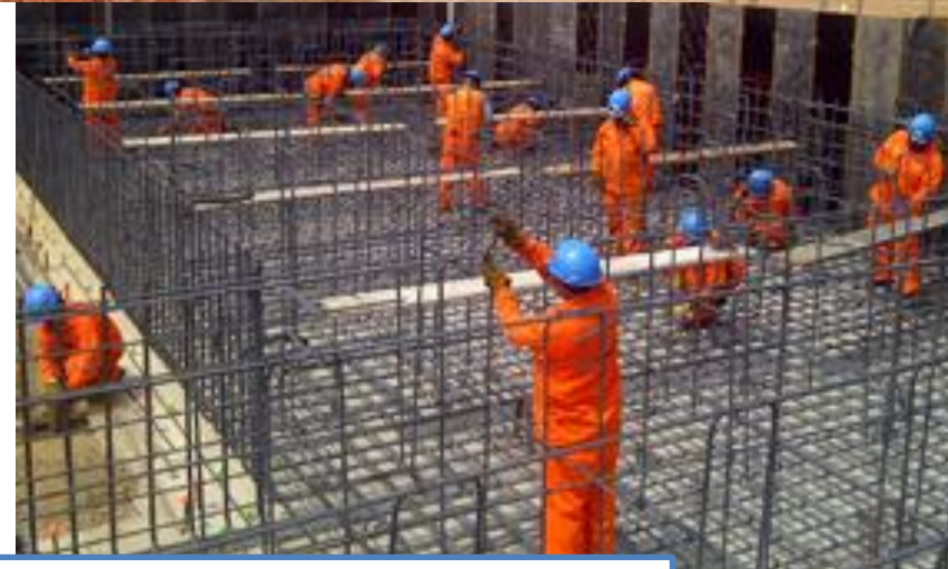
Planta de Poder Siemens, Chilca - Perú
