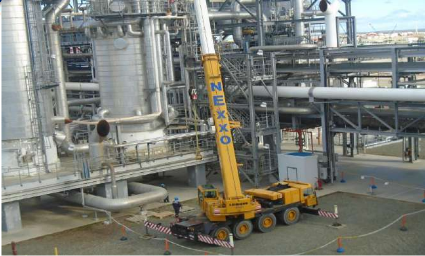
Methanex Re-Start Chile IV, Punta Arenas, Chile.
