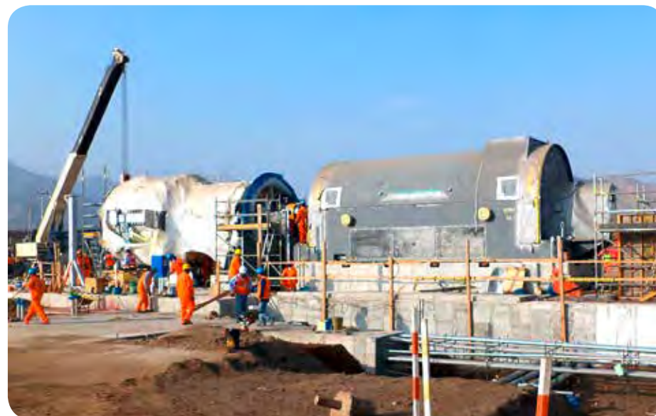
Turbina 208 MW, Central Santo Domingo de los Olleros
