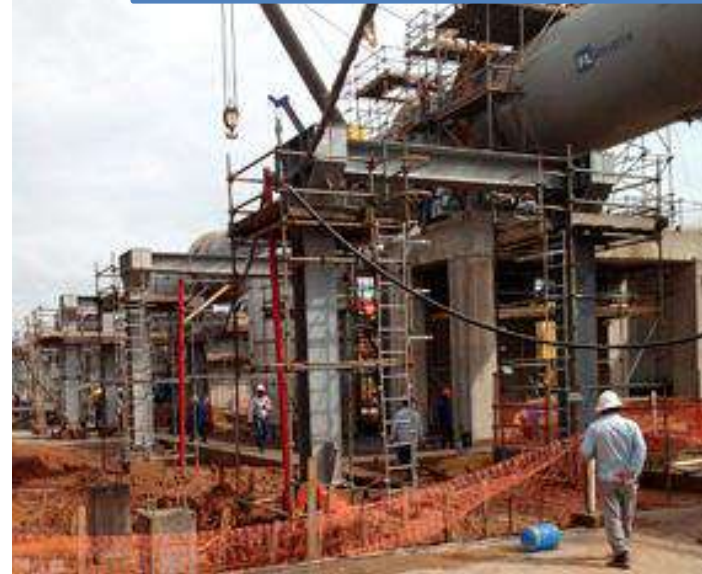
Caustificación y Patio de Maderas, Suzano - Brasil
