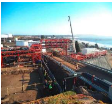
Terminal de almacenamiento LPG Quintero – V Región. Oxiqim
